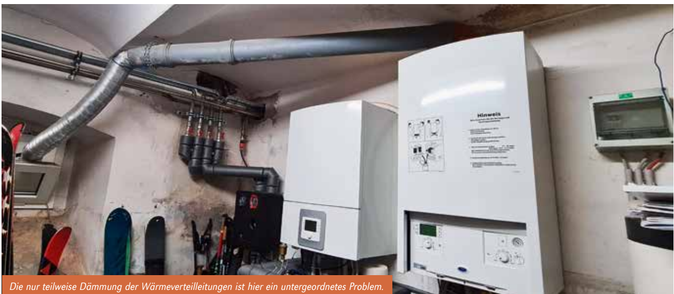
Schimmel- und Rostbildung oberhalb des Gerätes.
